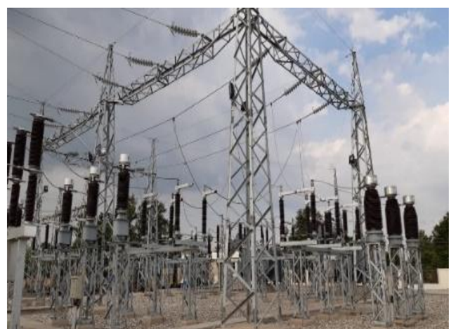
132kV AIS AILL Grid Faisalabad
